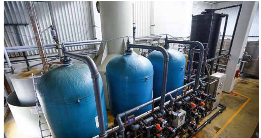
Optimizacija rada ionskih izmjenjivača čime se štedi 650 m 3 vode te se očekuje dodatna ušteda od 550 m 3 .
